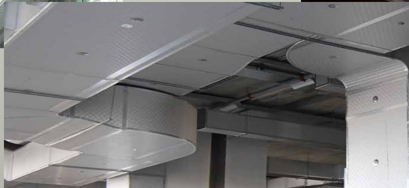
Gambar ducting yang sudah terpasang
